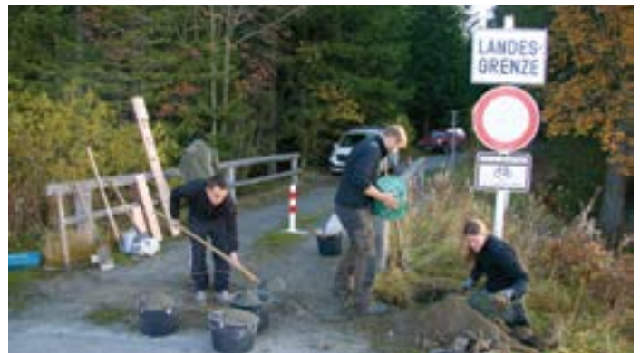
Aufbau einer Induktionsschleife zur Zählung von Radfahrern (Foto: Josef Štemberk)
