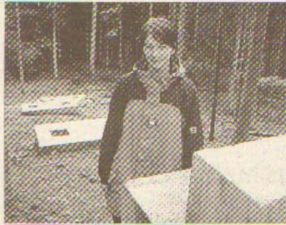
Susanne Gietl vor den Beton-Fundamenten, die in kurzer Zeit das Baumhaus tragen werden.
