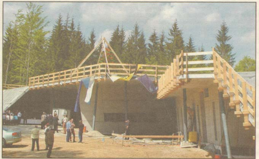
Richtfest für das künftige Informationszentrum „Haus zur Wildnis“ - ein futuristisch anmutendes Gebäude, das seinen Gästen einen freien Blick in das angrenzende Wolfsgehege und zum Falkenstein gewähren wird.
