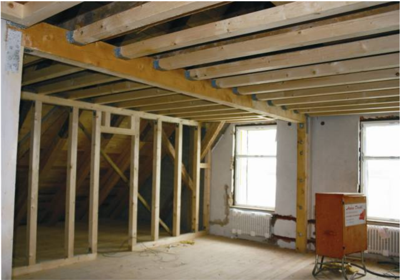
Abbildung 46: Das Dachgeschoß des Verwaltungsgebäudes in Grafenau wurde komplett erneuert (Foto R. Pöhlmann).
